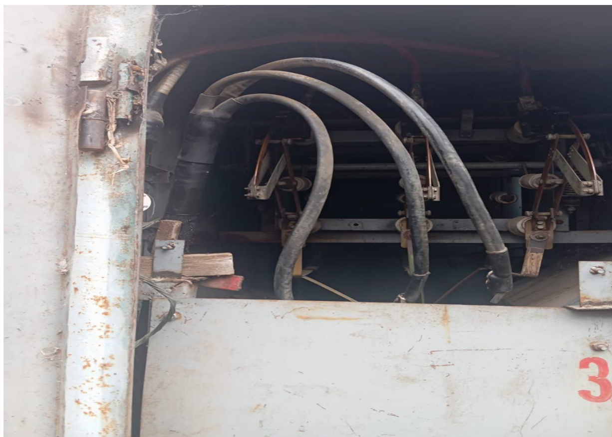
4.3 КЛ 6 кВ «А», «Б» ТП-748 – ТП-1019п. РУ-6кВ ТП-1019п
