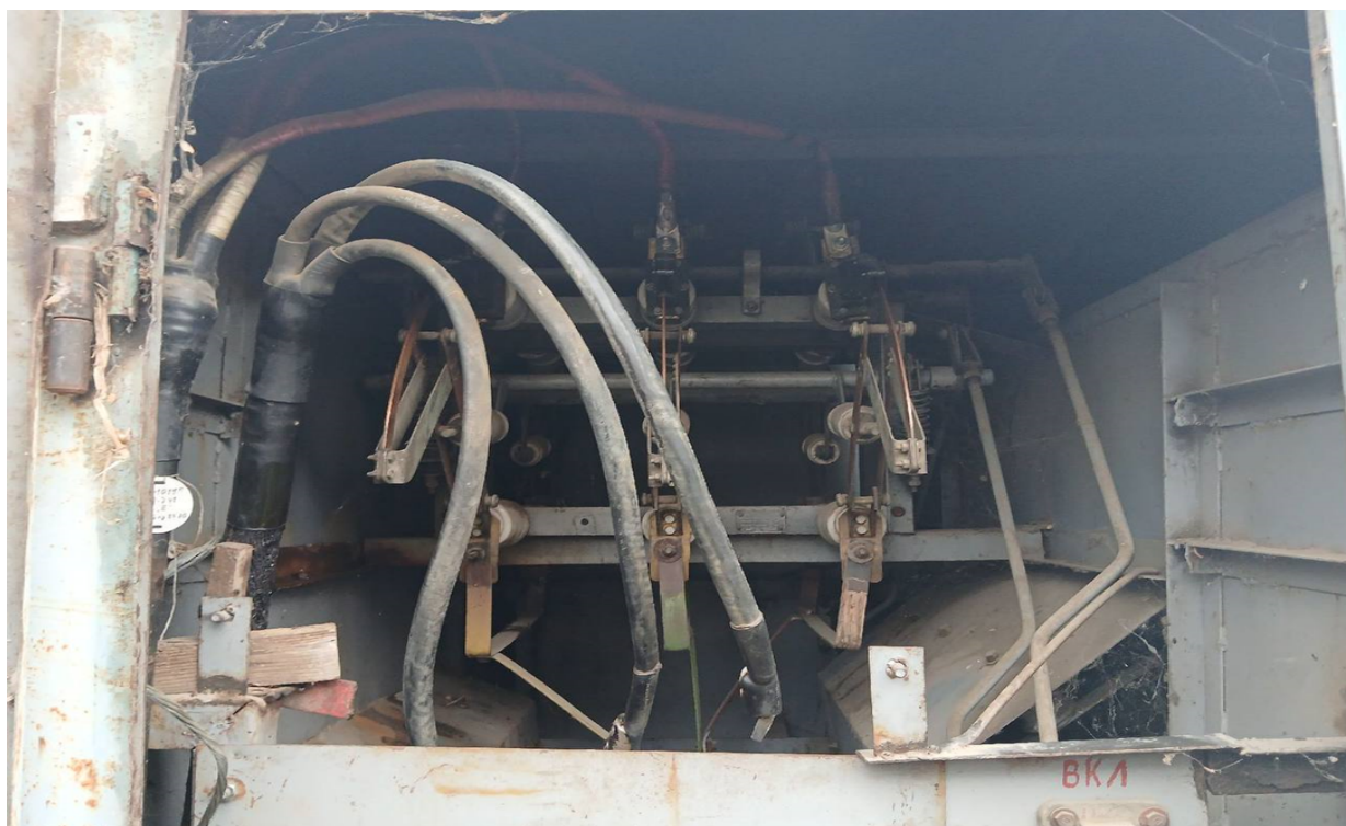
4.2 Распределительное устройство 6 кВ ТП-1019п. Внутренний вид.
